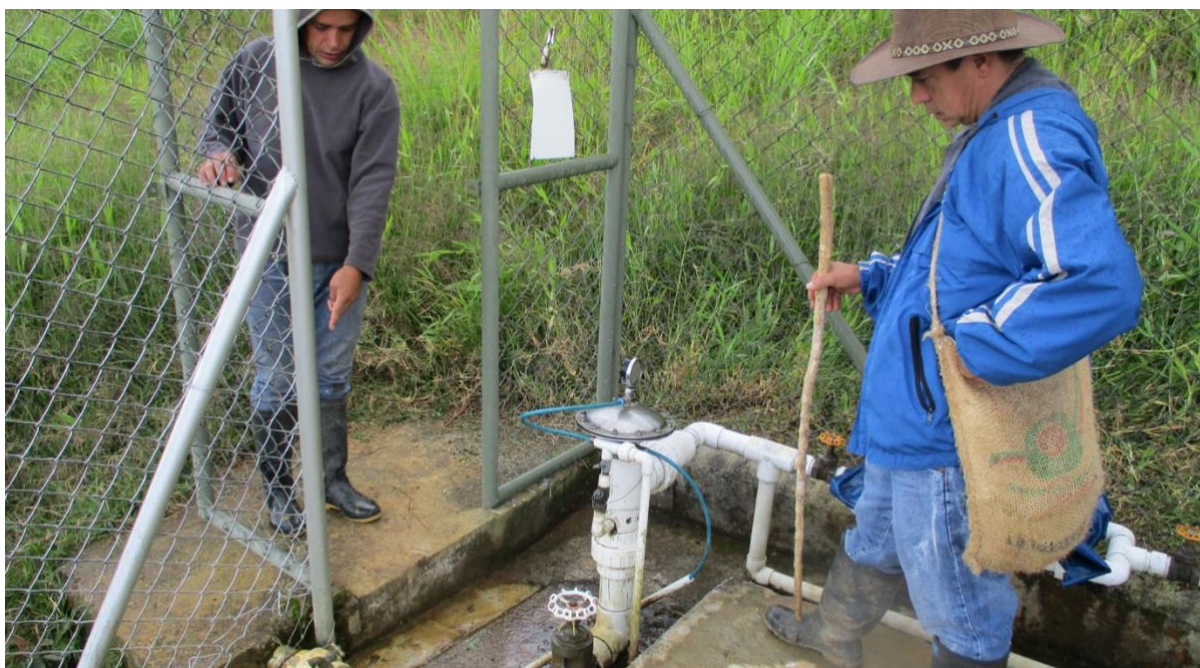
Station de traitement de l'aqueduc Manga Arriba dans la municipalité de Girardota en 2018 (source: Brendan Ecuver)
